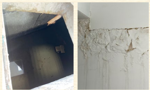
床下は水浸しの状態となっており、漏電漏水の危険
